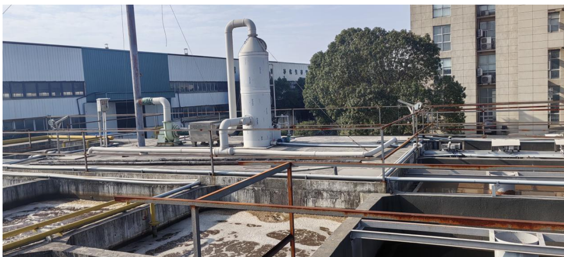
废水处理设施
