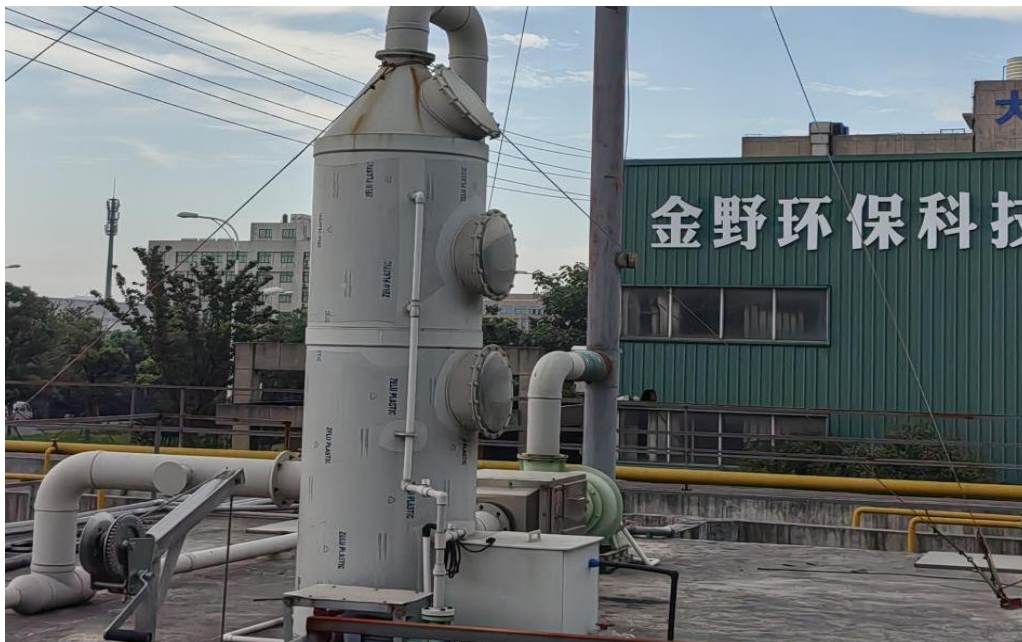
废水处理设施废气处理设施
