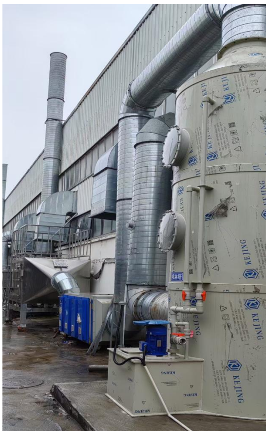
储存车间 2 废气处理设施
