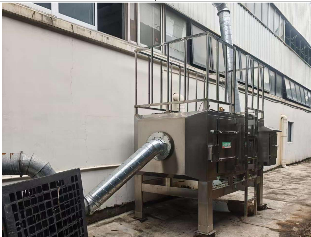
注塑（吹塑）废气处理设施
