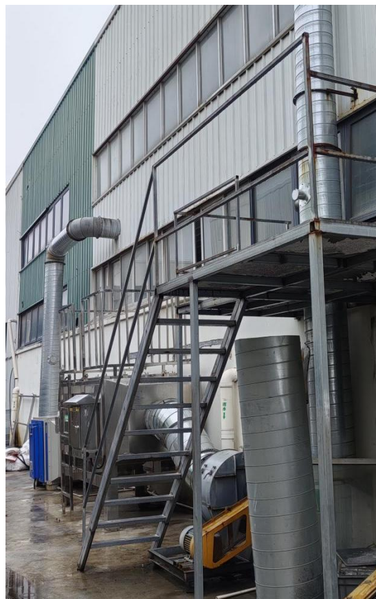
废机油滤芯废气处理设施
