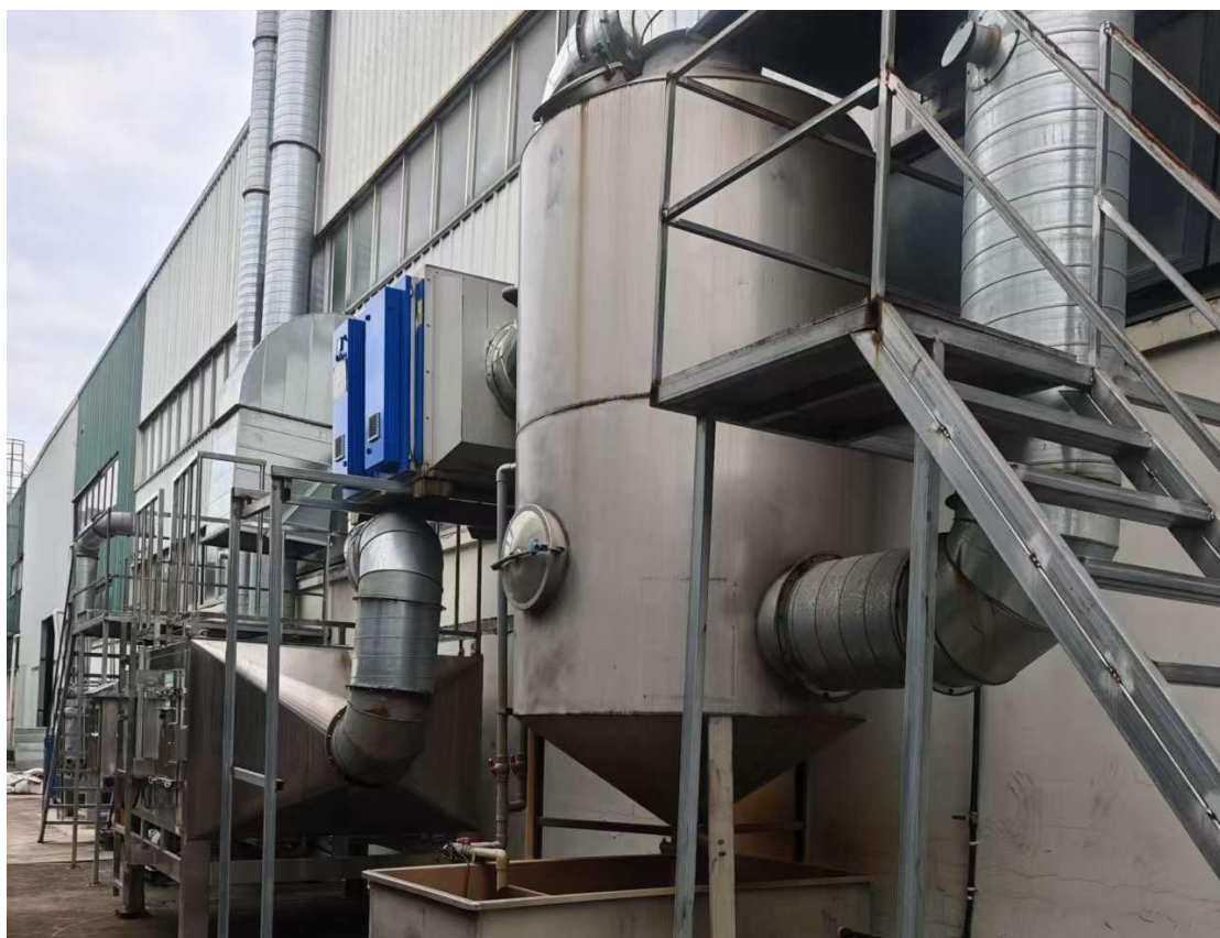
废塑料桶处理线废气处理设施
